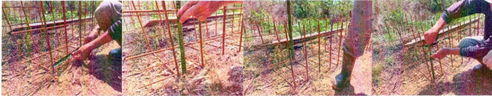
ภาพ ขณะดำเนินการ โครงการก่อสร้างระบายน้ำรูปตัวยู หมู่ที่ ๘ สายสามแยกบ้านนางยุพิน มงคล(ข้างโรงเรียน)ถึงสามแยกบ้านครุกาญจนา วงค์ศรีซา
